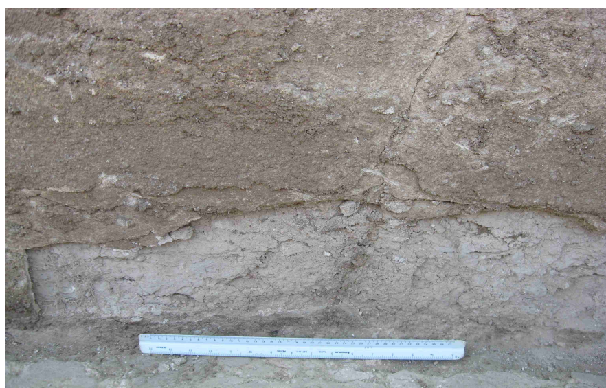
איור 5 : שתי שכבות הטיח באזור בו נשדד הקיר הצפוני.
